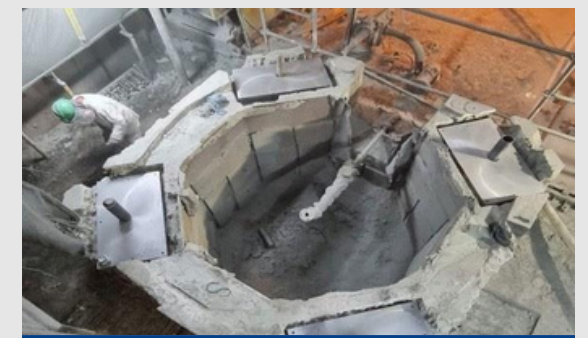
Mantención área de chancado
